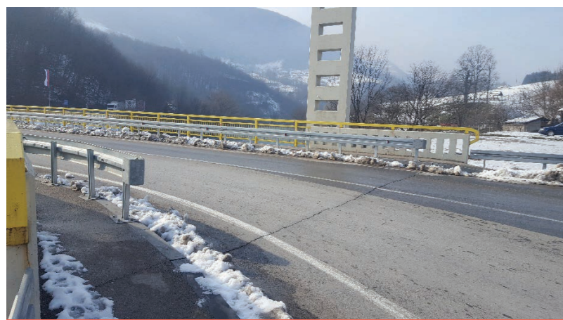
↑ Slika 16: Pukotina u asfaltu na mjestu kraja prelazne ploče (zimski period)
