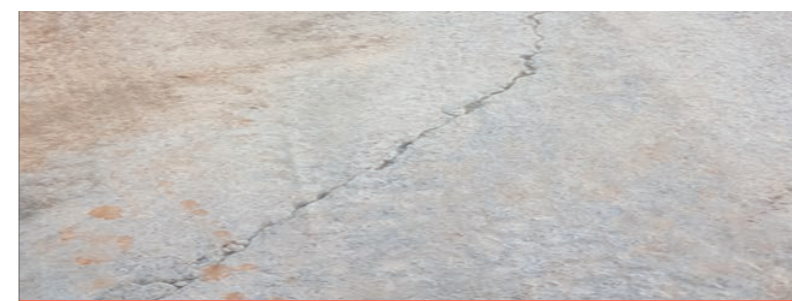
↓ Slika 9: Pojava pukotina na deonici
