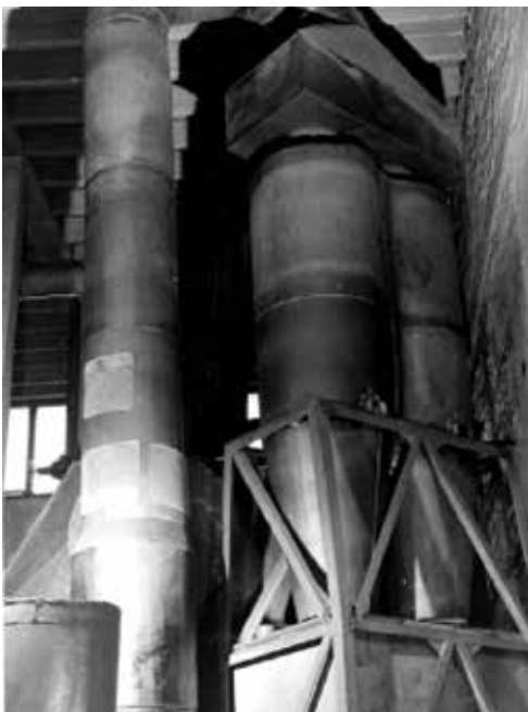
Fotografija ciklonskog odvajачa u kotlovnici na ugali Grbavica II, Sarajevo
