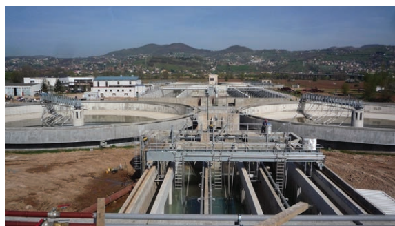
Slika 2. Aerisani pjeskolov i primarni taložnici
