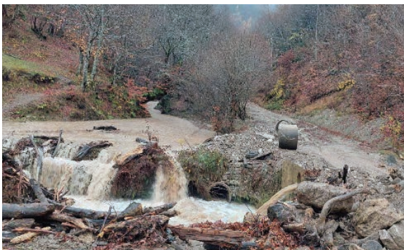
Slika 14. Pojava bujičnog toka na potoku Lučica
